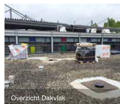
Schadebeeld PVC Dakbedekking
